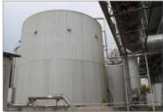
Figura 8.5 Digestor de la planta de biogás del Grupo Ganser
