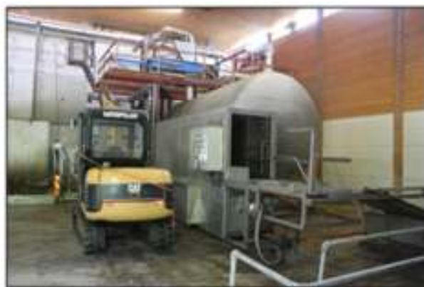
Figura 9.4 Sala de recepción con unidad de lavado automático para la limpieza de los contenedores
