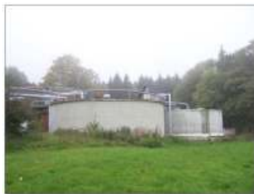
Figura 9.5 Digestores de FITEC
